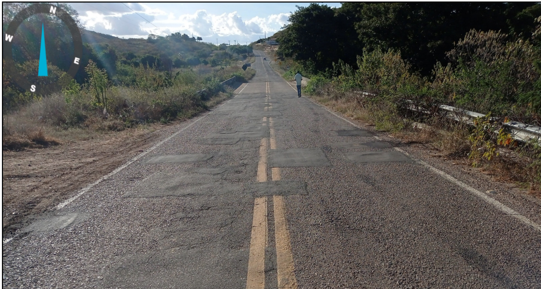
Foto 4 – Plataforma revestida em TSD com muitos remendos e desgaste.
