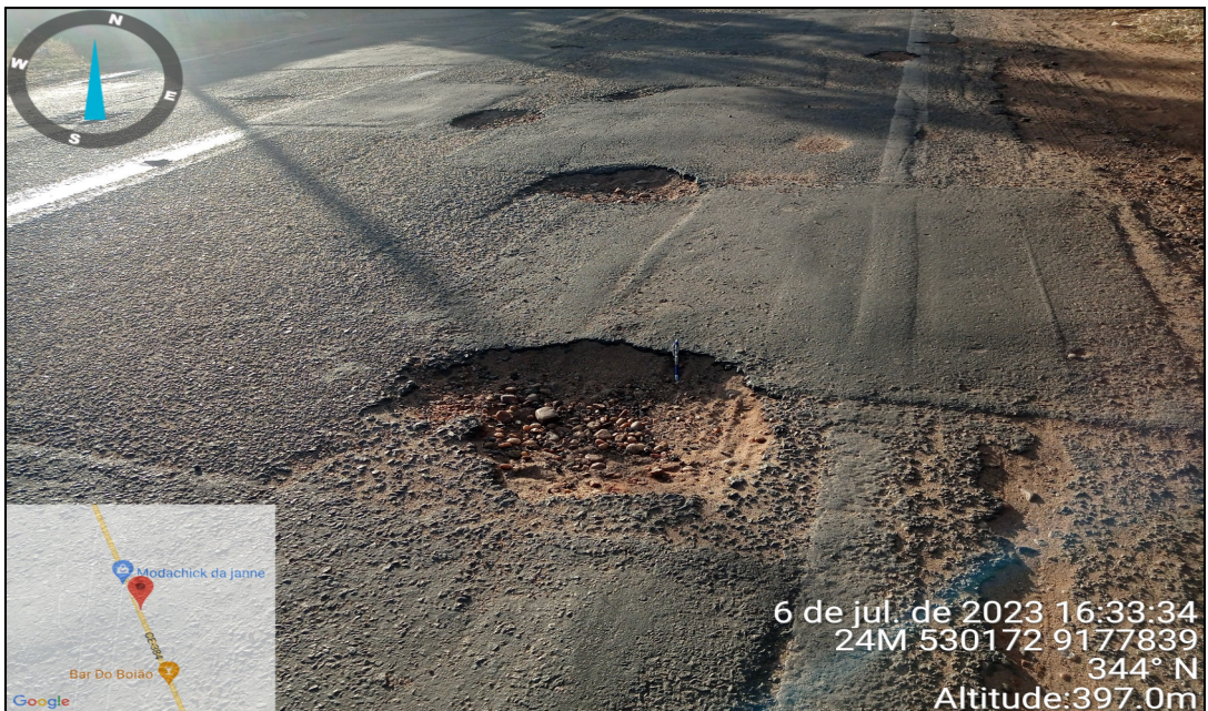
Foto 5 – Segmento apresentando diversos buracos (panelas).
