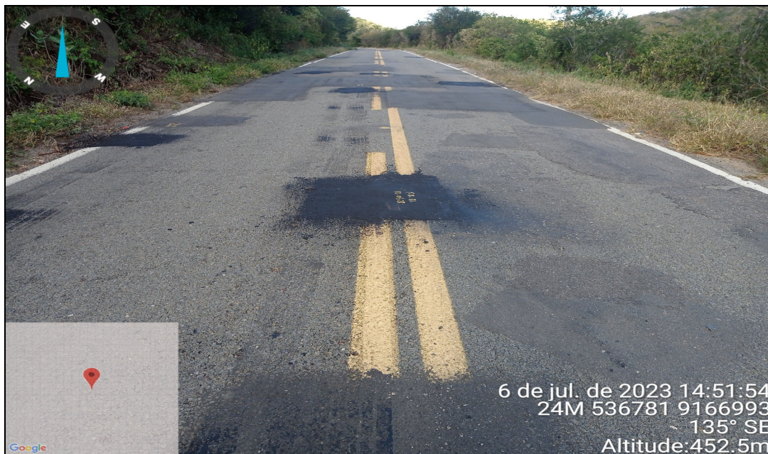
Foto 6 – Plataforma revestida em TSD com muitos remendos.
