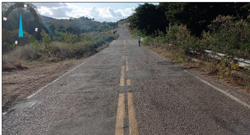
Foto 4 – Plataforma revestida em TSD com muitos remendos e desgaste.
