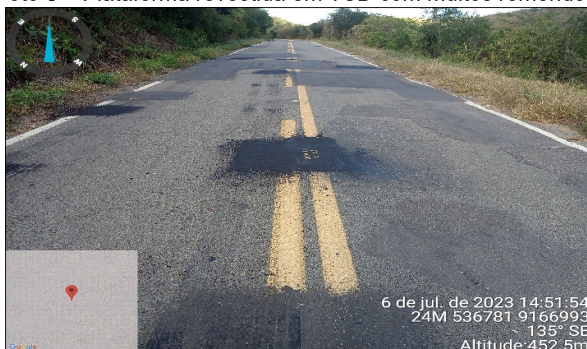
Foto 6 – Plataforma revestida em TSD com muitos remendos.
